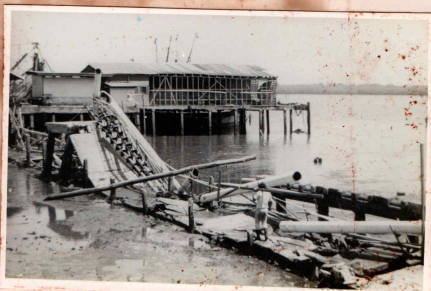
FOTO 6: Daños en el Muelle de Frigoríficos, ubicado en el estero de Puntarenas, por licuefacción del suelo. Temblor del 25 de marzo de 1990.
