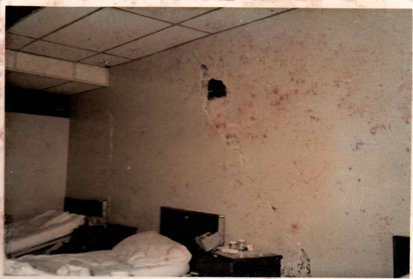
FOTO 4: Daños en el Hospital Monseñor Sanabria de Puntarenas. Temblor del 25 de marzo de 1990.
