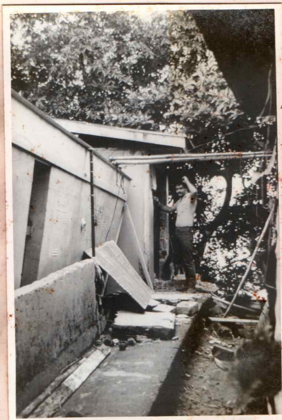
FOTO 17: Daños en estructuras de madera por los sismos de Puriscal de mayo a junio de 1990
