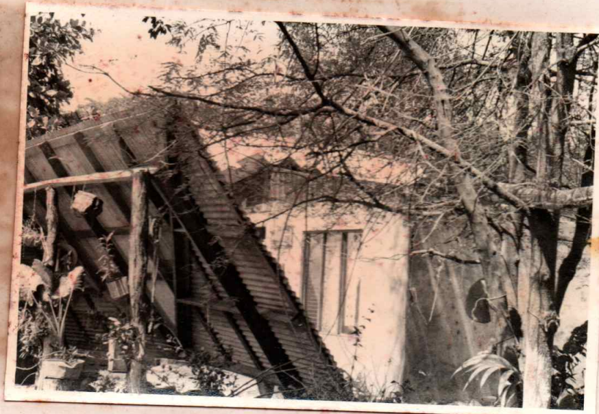
FOTO 11: Colapso de un techo por no estar bien unida a la estructura principal, sismo del 25 de marzo de 1990.
