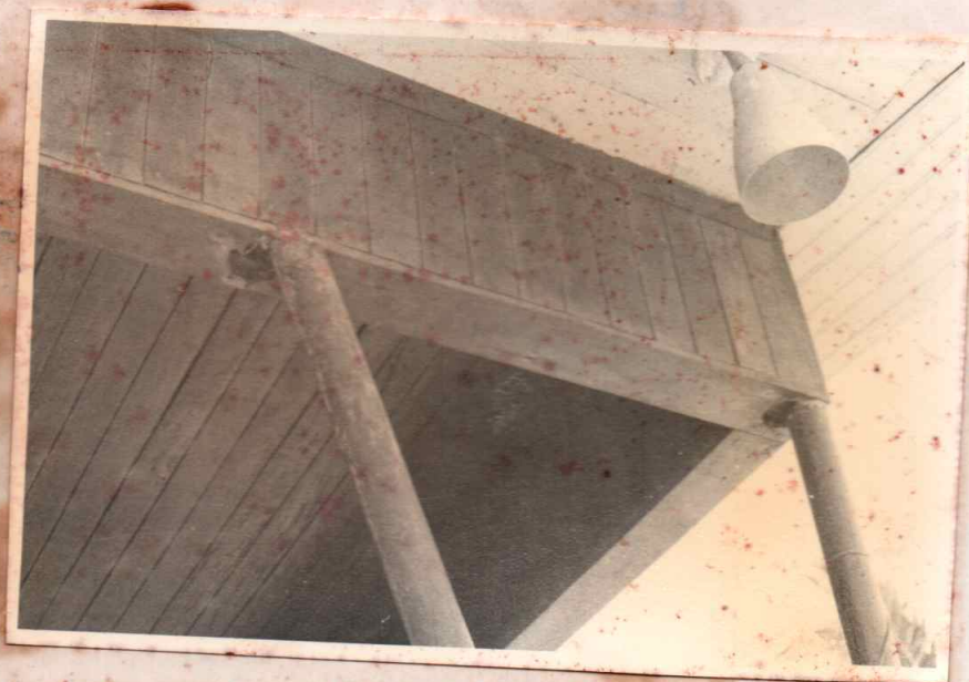
FOTO 12: Tubos de sostén salidos de sus agujeros debido al salto de la estructura que sostenían, como consecuencia del sismo del 25 de marzo de 1990.
