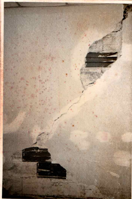
FOTO 5: Daños en paredes del Hospital Monseñor Sanabria, sismo del 25 de marzo de 1990. Esta pared ya había sido reparada por daños ocasionados por el temblor del 2 de abril de 1983.
