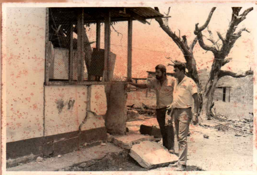
FOTO 7: Daños estructurales en casa mal construida Piedras Negras, Cóbano. Temblor del 25 de marzo de 1990.
